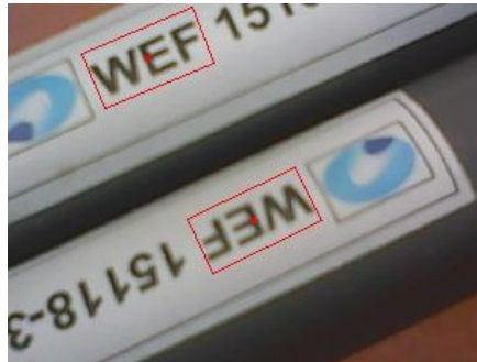
Gambar 2. Pipe label sesuai dengan ROI
